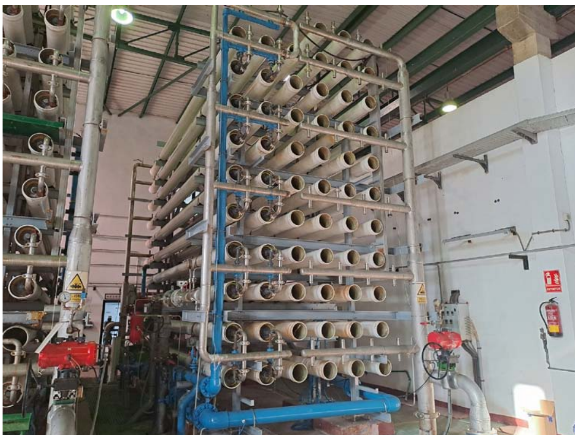
Mejoras estacion desaladora Racons Denia
