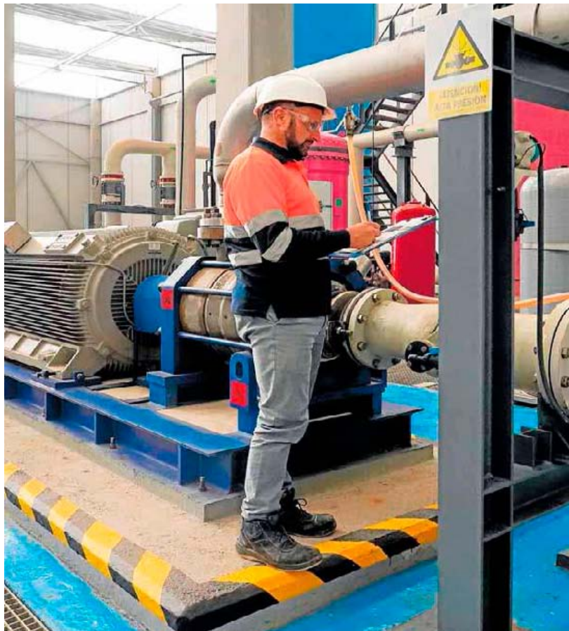
Un operario en la planta de desalinizadora de Sagunto. EP
