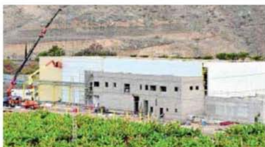
La desaladora tiene este aspecto exterior y es la pieza más avanzada. A. S.
